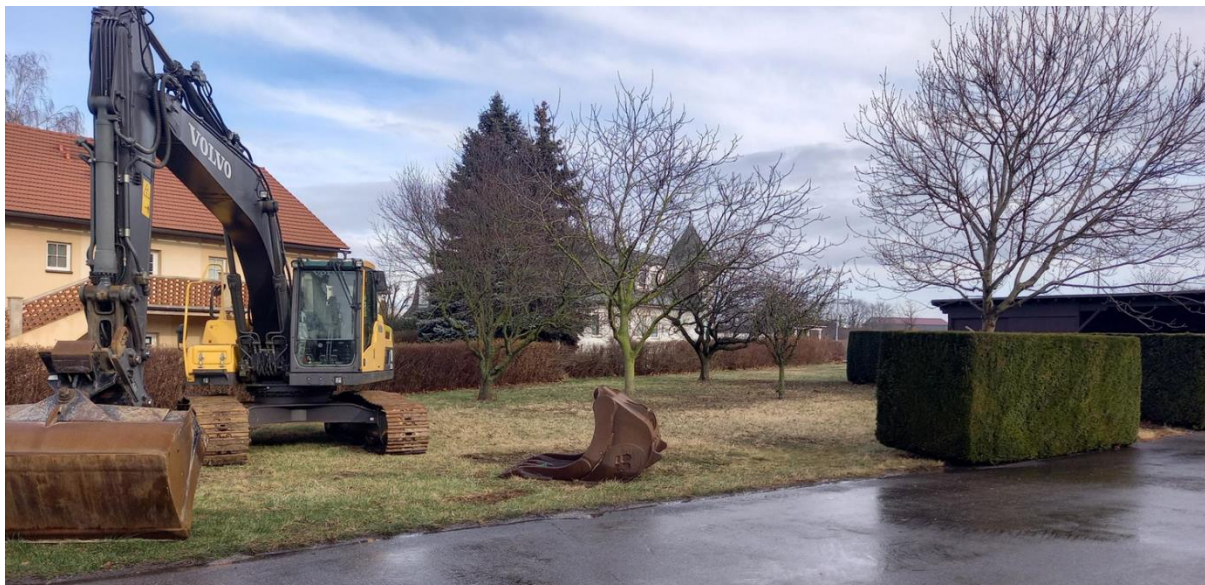
Abbildung 35: Fläche, auf der die Hackschnitzelheizung inkl. Lagerung des Hackguts errichtet werden soll.
